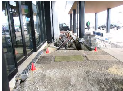
段差の生じた庁舎入り口付近
