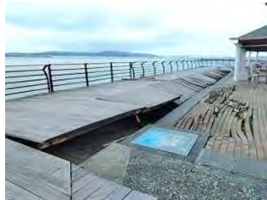
七尾マリンパークにおける液状化被害
