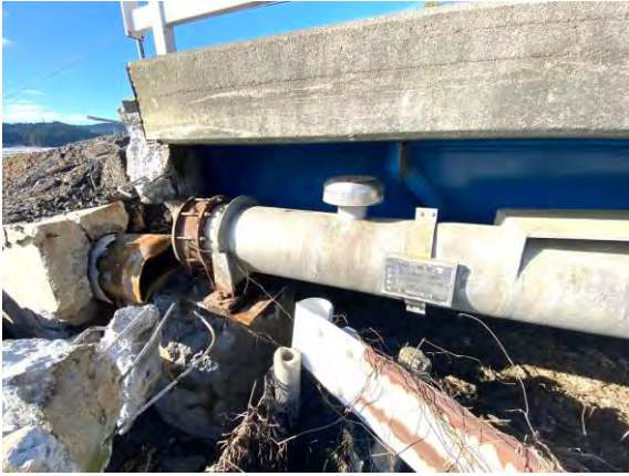
写真3 水管橋の破損 (珠洲市内)
