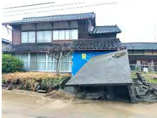
家屋被害玄関先の様子
