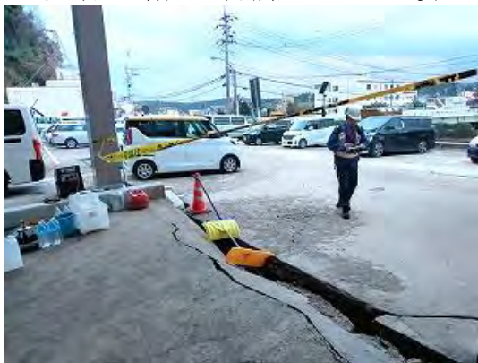
庁舎玄関の地盤被害
