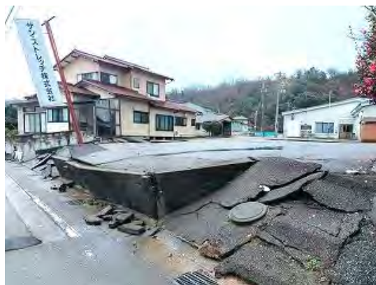
アスファルトがめくれ上がっている。
