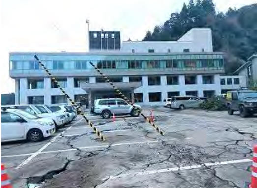
穴水町役場前の駐車場の地盤被害 (庁舎の3階は避難所となっている。)
