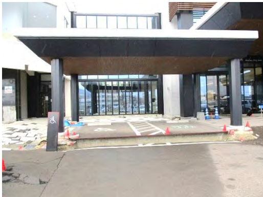
段差の生じた正面玄関
