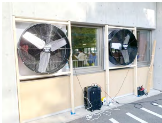
写真7 直径1mの換気ファン2機
