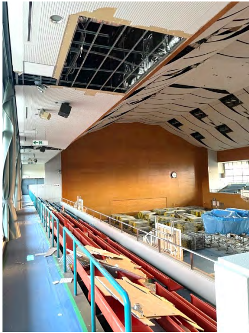
写真1 市の施設（体育館）の被害
