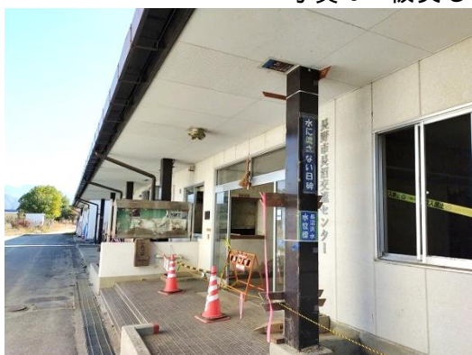
写真4 被災した長沼交流センター
