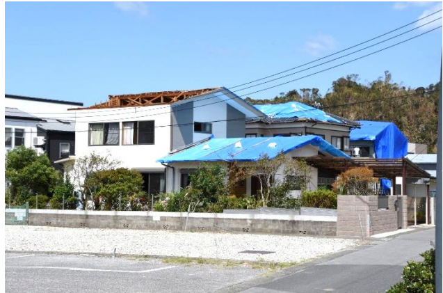
写真1 南房総市で被災した住宅。比較的に新しい家でも窓が割れ、そこから風が入り込み屋根が吹き飛ばされたと見られる （筆者撮影）
