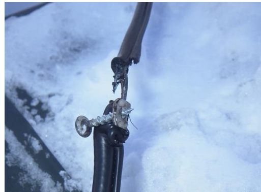
写真6 屋根上の同軸ケーブル及びA線の状況
