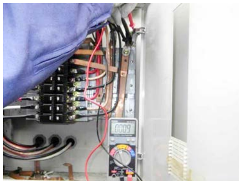
写真12 黒色配線とヒンジの導通確認
