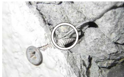
写真15 ネジとワイヤーラスの状況
