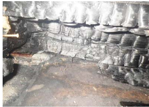
写真9 モルタル壁変色箇所
