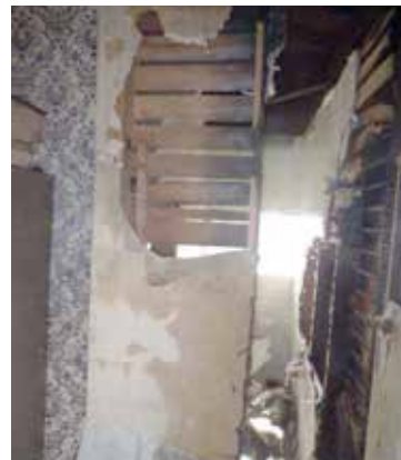
【写真3】2階トイレ付近及び天井裏
