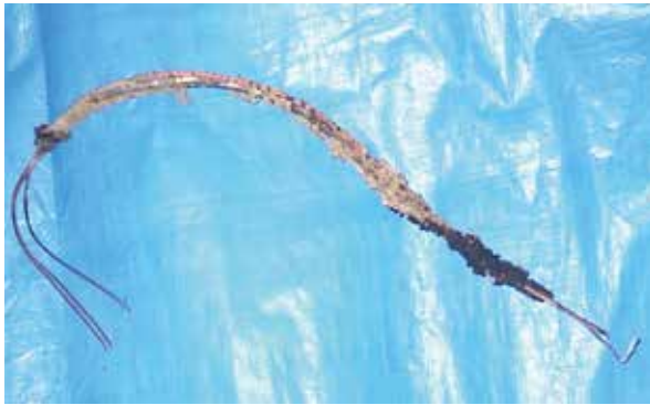
【写真9】 シロアリの巣に巻き込まれた引込線 (1階天井裏付近)
