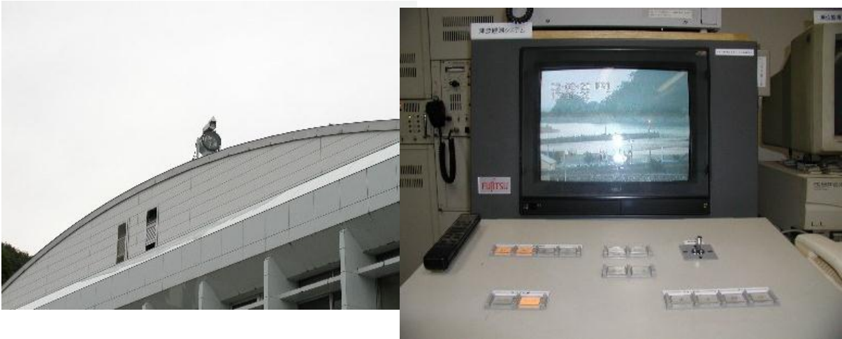
写真 2-5 津波観測システム（左：カメラ（総合事務所屋上）、右：モニター）
