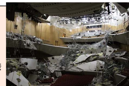
天井被害の例 (ホール／神奈川県川崎市)
