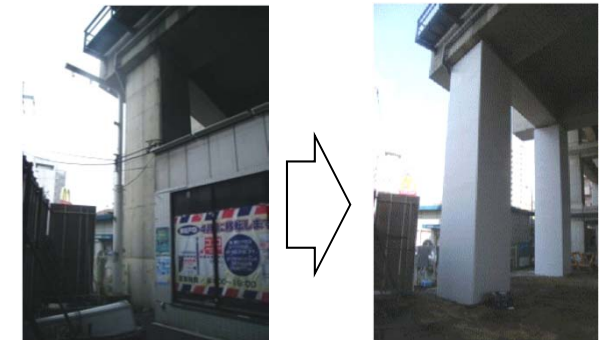
鉄道駅の耐震補強の例 （コンクリート製の柱に鋼板を巻き補強）
