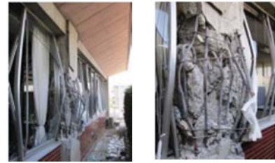
市役所本庁舎の被災状況
