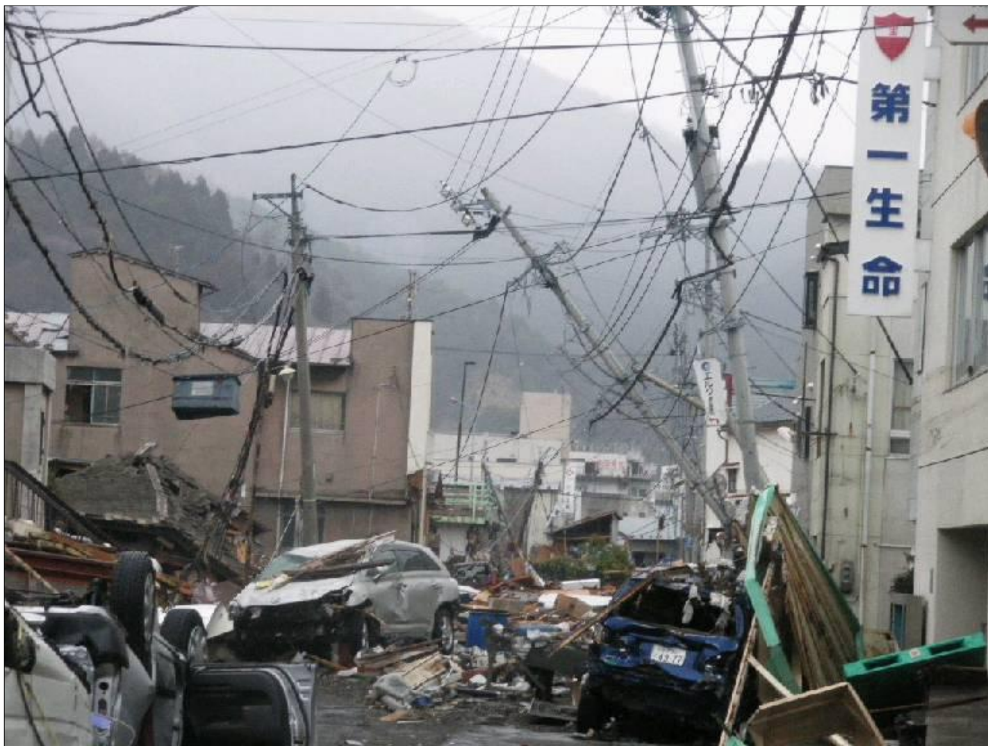
津波により漂流物が大量に流れて電柱が傾斜 (岩手県釜石市)
