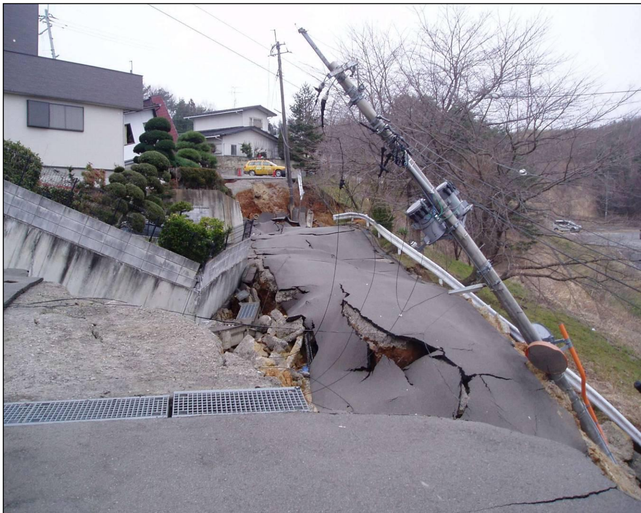
道路損壊による電柱傾斜（福島県福島市）
