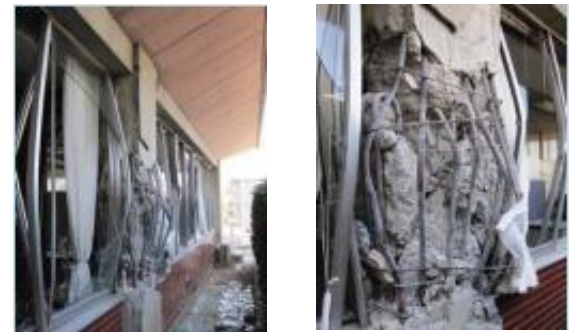
市役所本庁舎の被災状況
