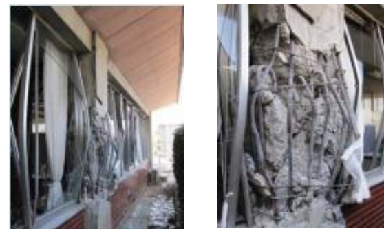
市役所本庁舎の被災状況
