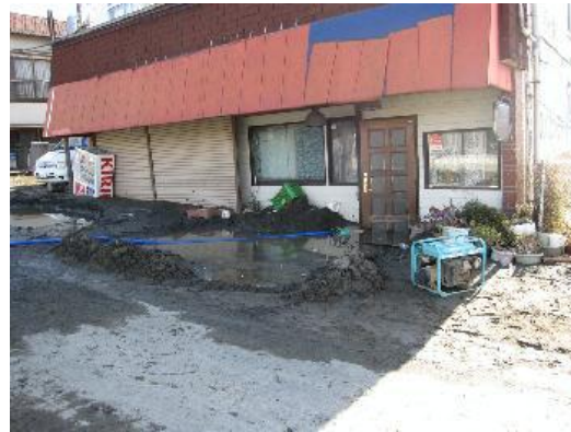
建物への被害(千葉県我孫子市)
