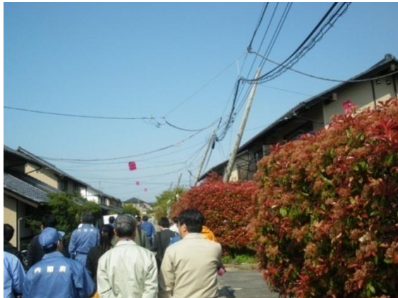
電柱の傾斜(茨城県潮来市)
