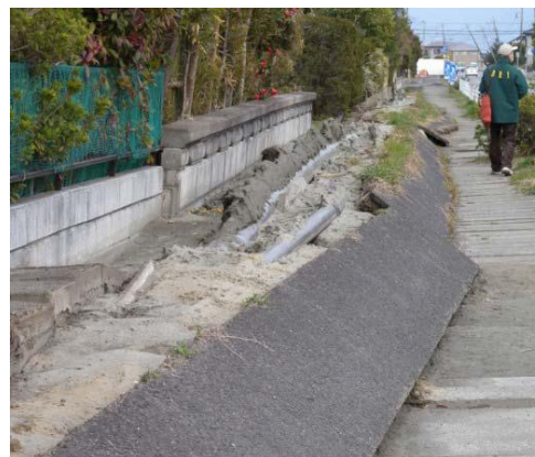
埋設配管の浮き上がり(茨城県潮来市)
