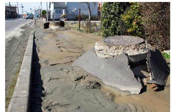
マンホールの浮き上がり(千葉県香取市)
