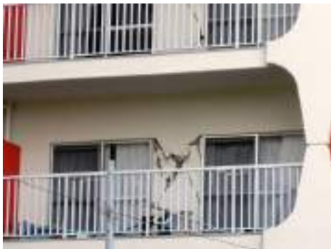
写真 5.2.1-13 非構造壁（バルコニー側）のせん断破壊
