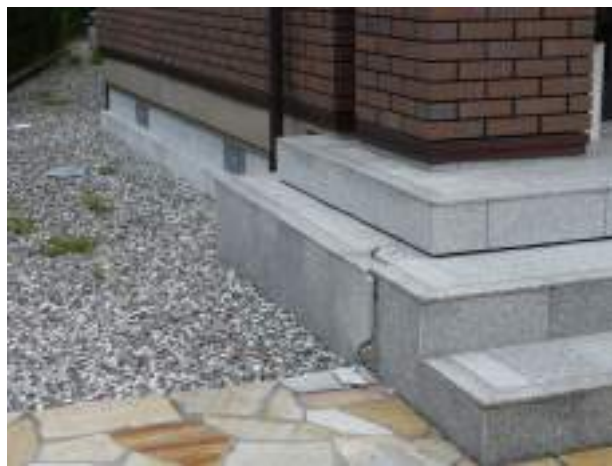
写真 5. 5. 1-34 玄関口の損傷
