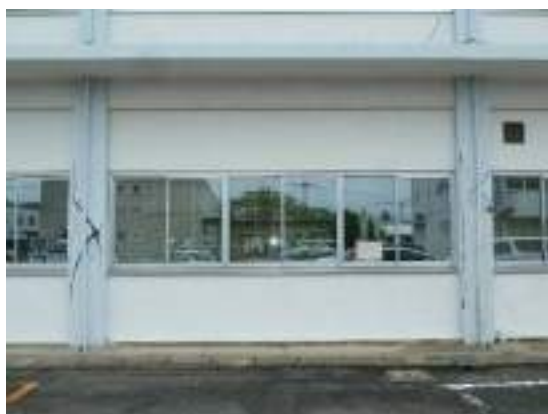
写真 B-39 柱のせん断破壊（損傷度 IV）
