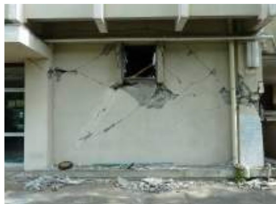
写真 B-46 開口付き耐力壁のせん断破壊 (損傷度 V : ㊦通り①-②間)
