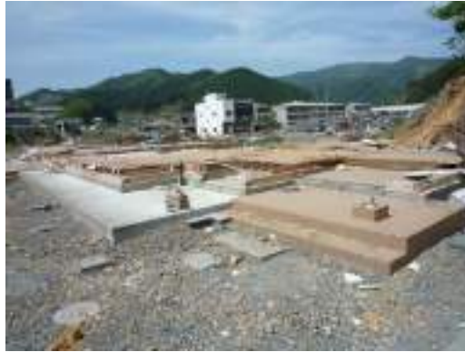
写真 10.10 流失した比較的新しい家屋の基礎、土台、床板（浸水深 6 m 以上）
