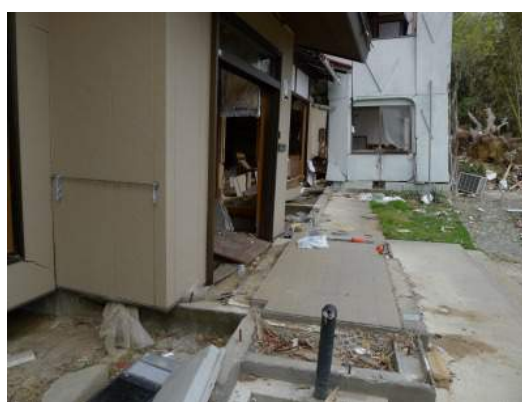
写真 16.4 移動した脚部
