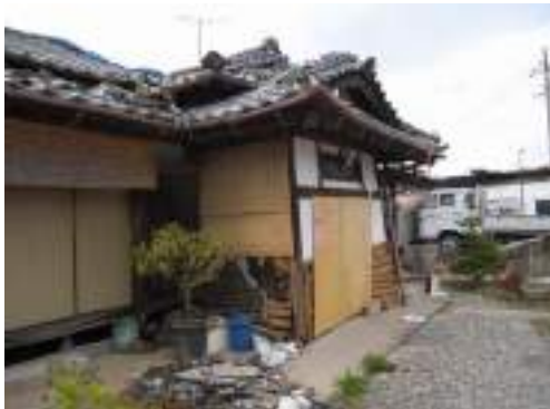
写真 5. 4. 2-7 玄関部の分離、傾斜
