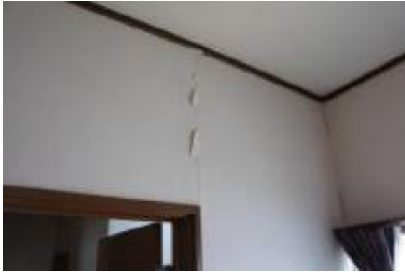
写真 5. 4. 2-13 内壁クロスの切れ
