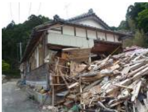
写真 20.12 入射方向の部分を損傷して残存する 木造家屋
