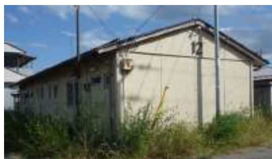
写真 4.2 外壁に残る浸水痕
