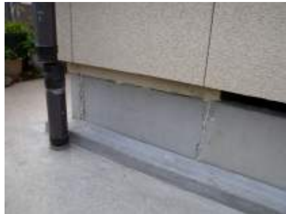
写真5.5.1-42 基礎立上り部の補修跡
