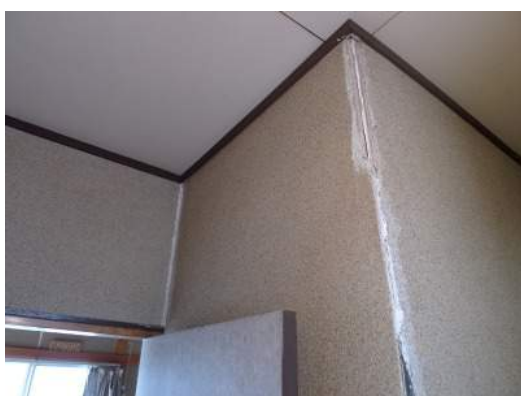
写真 5. 4. 2-25 内壁ラスボードの亀裂
