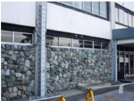
(a) 建築物A（損傷度V）
