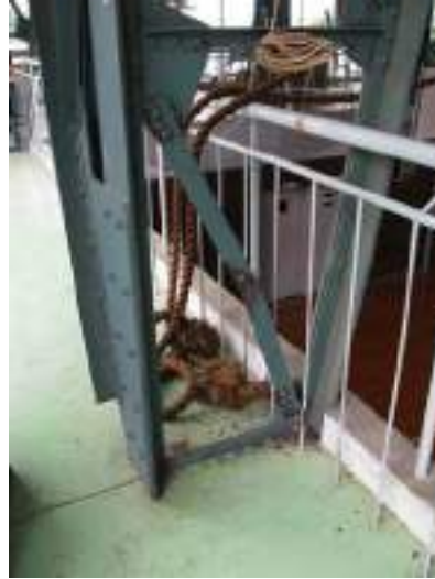
写真 5.3-2 ラチス柱斜材の座屈
