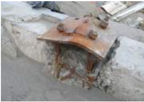
写真6.3.1-1 柱脚部の破断
