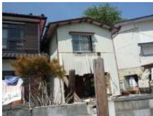
写真10.2 写真10.1に隣接し、土台ごと移動した作業小屋
