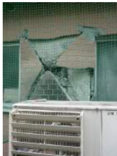
写真 B-30 北構面方立て壁のせん断破壊
