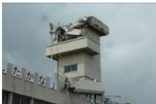
写真 5.2.1-4 塔屋の損傷及び落下
