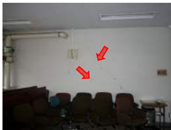
写真 B-11 耐力壁のせん断ひび割れ (1階、損傷度 III)
