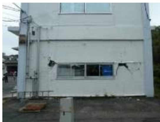
写真 B-40 コンクリートブロック造壁の破壊 (X4 構面)
