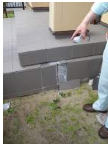
写真5.5.1-44 玄関階段部分の損傷
