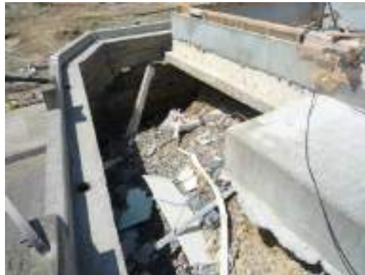
写真 10.12 写真 10.10 の北隅の洗掘孔
