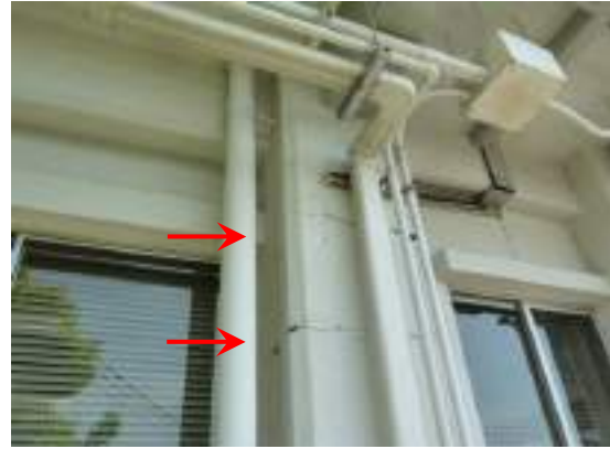
写真 5. 2. 3. 3-4 建物梁間方向の柱頭曲げひび割れ (A-9)
