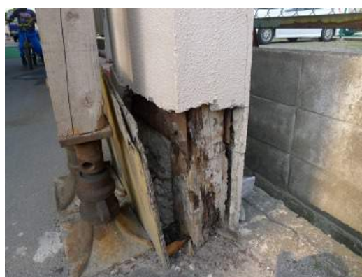
写真 5. 4. 2-24 門型架構 脚部の生物劣化
