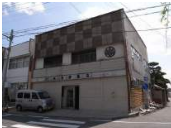
写真 5. 4. 2-31 外観（モルタル外壁の落下）
