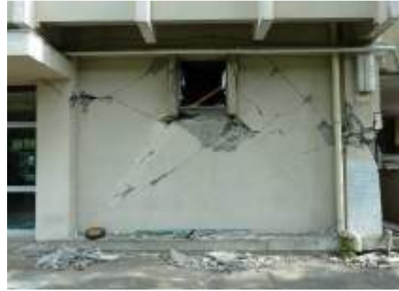
(b) 建築物 I (損傷度 V)
