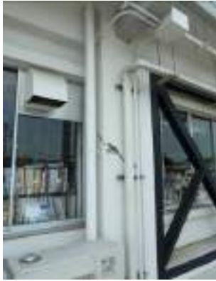
写真 5.2.1-9 鉄骨ブレースが取付いた 柱のせん断ひび割れ
