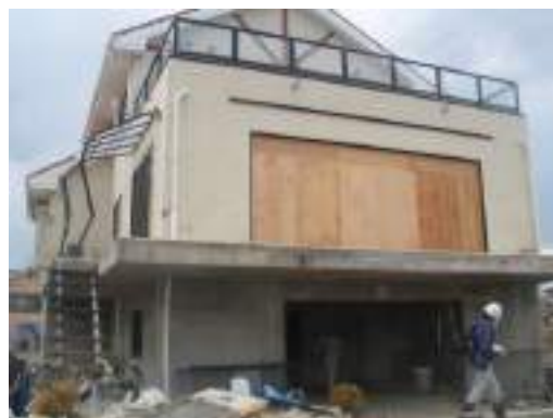
写真6.4.1-11 1階RC構造(壁式構造)で残存する事例(2)
