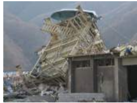
写真6.3.1-2 柱脚部アンカーボルトの破断により移動したと考えられる建築物
