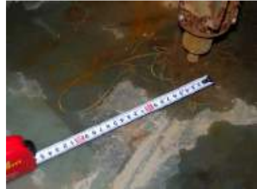
写真 5.5.1-11 罫書き式変位計による記録
