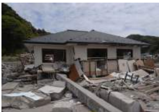
写真 20.17 流された軽量鉄骨造 (⑬)
