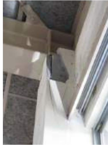
写真 5.3-4 RC 柱と屋根接続部コンクリート剥離
