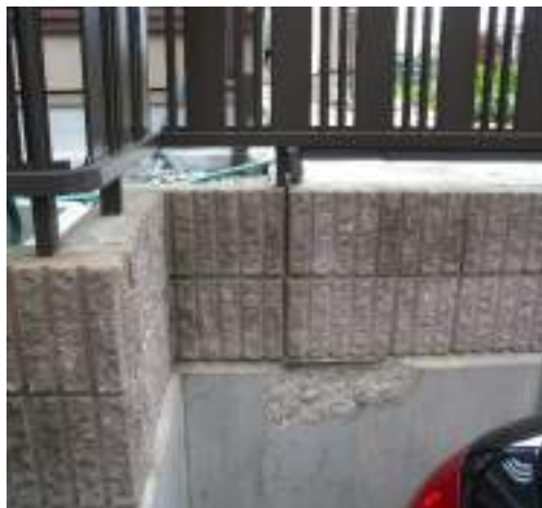
写真 5. 5. 1-33 ブロック塀脚部の被害
