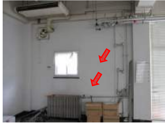
(b) 建築物G (損傷度 II)
