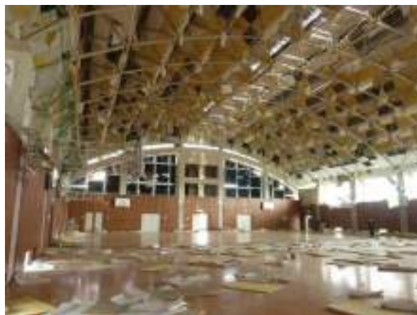
写真 5.7-4 天井板のみ全面的に脱落した被害
