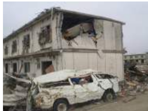
写真6.2.1-15 漂流物の衝突により生じた壁の開口
