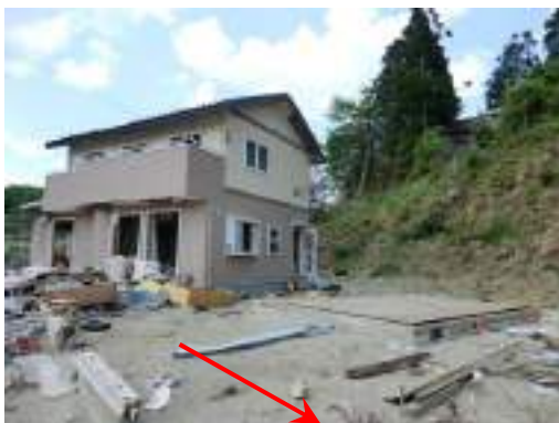
写真 7.14 M邸 (奥) と流失した建物の 基礎と床組部分 (手前)
