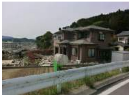
写真 13.11 写真 13.1 の左手前の建物。軒下まで浸水
