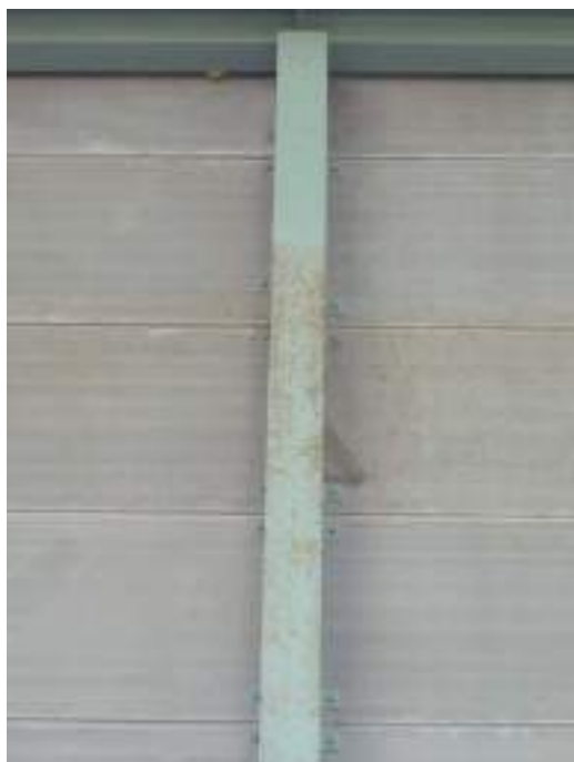
写真2.3 屋内運動施設内側の浸水痕
