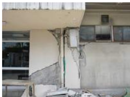
(b) 建築物I（損傷度V）
