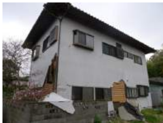
写真 5.4.2-12 モルタル外壁の脱落
