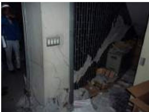
(a) 耐力壁のせん断破壊
