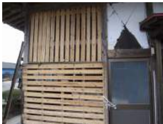
写真 5.4.2-10 脱落した外壁の仕上げと破断した筋かい
