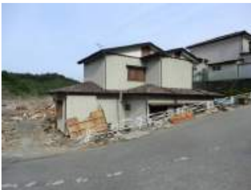
写真 13.18 廻館地区の傾斜地に建つ木造住宅 (写真 13.9 よりもやや高い場所に建ち、1階の開口部上部まで浸水)
