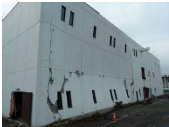
写真 6.2.5-1 耐震壁の面外変形
