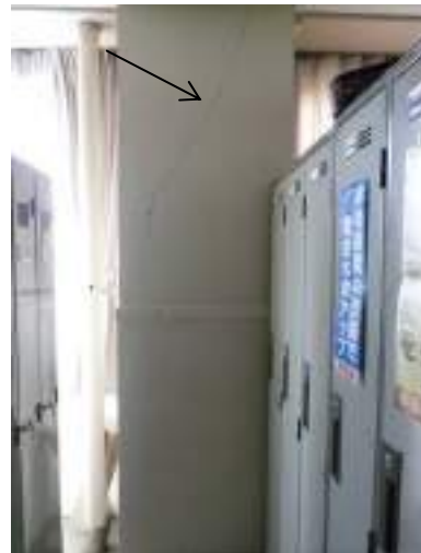
写真 B-22 柱のせん断ひび割れ (3 階、損傷度 III)
