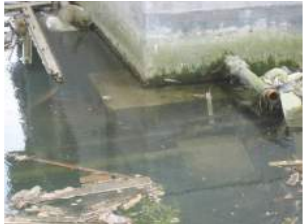
写真 6.2.7-2 洗掘により露頭したフーチング（写真 6.2.7-1 の棟の北東隅部）
