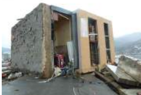
写真 6.2.1-4 3階建て直接基礎建築物の転倒
