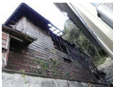
写真 7.2-10 出火した住宅
