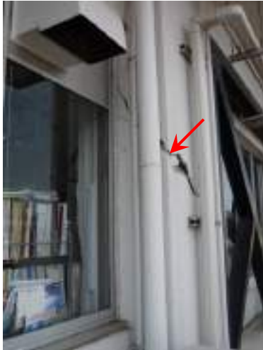
写真 5. 2. 3. 3-3 ブレースが取り付け付く柱の構面内及び構面外に生じたせん断破壊 (C-8)
