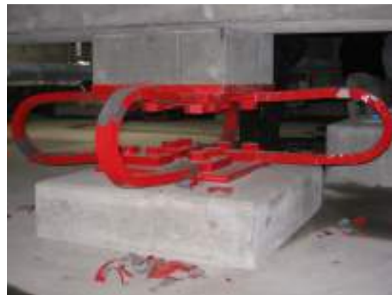
写真 5.5.1-16 U型鋼材ダンパーの塗料はがれ
