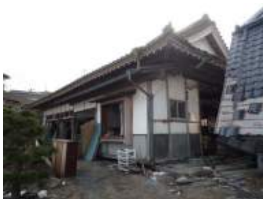
写真 12.8 転倒した 2 階建ての隣の家屋
