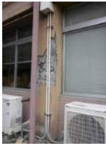
(b) 建築物F（損傷度IV）
