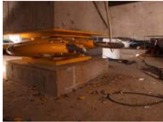
写真 5. 5. 1-19 鋼棒ダンパーの塗装剥がれ
