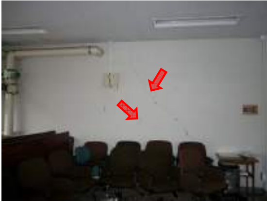
(a) 建築物B' (損傷度 III)
