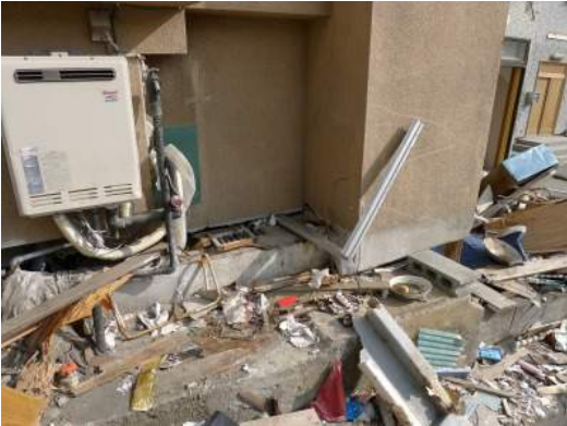
写真 4.11 前写真の基礎上端のずれ
