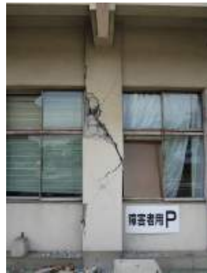
写真 B-44 短柱のせん断破壊 (損傷度 V : ㊦通り⑩柱)
