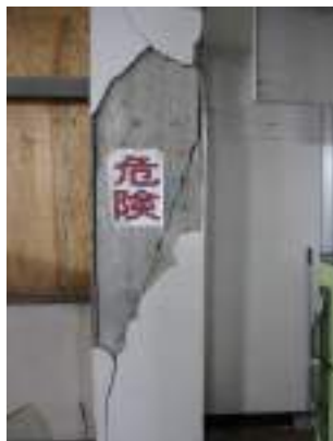
写真 B-6 腰壁付き短柱のせん断ひび割れ (1 階 4-L、損傷度 III)
