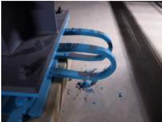
写真 5. 5. 1-31 鋼材ダンパーのゆがみ・塗装剥がれ
