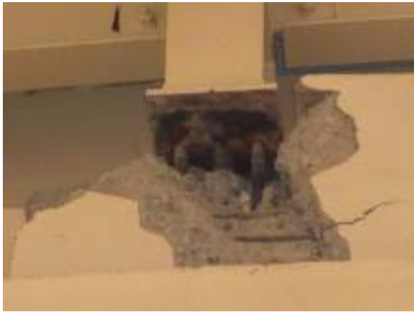
写真 5.3-12 RC 柱と S 造屋根接続部（支承部）のコンクリート剥落、ボルト変形
