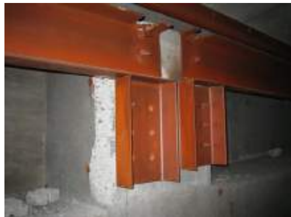
写真 5.3-9 妻壁と S 造屋根接続部ホールインアンカー抜け出し
