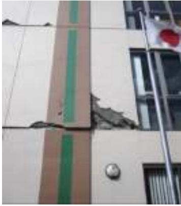
写真 5.2.1-11 袖壁脚部の損傷
