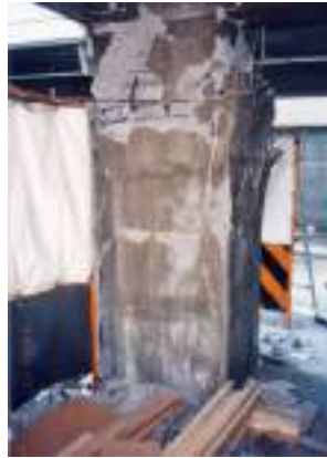
(b) 柱主筋段落とし部の破壊 (表 5. 2. 1-1 の 4))
