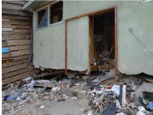
写真 4.6 前写真の1F 柱脚部の状況
