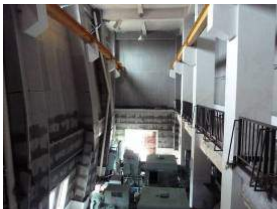
写真 6.2.5-3 建築物内部の浸水痕跡
