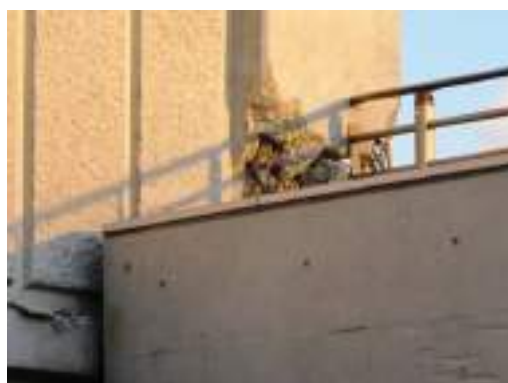
写真 5.2.1-6 連層耐力壁側柱脚部の圧壊
