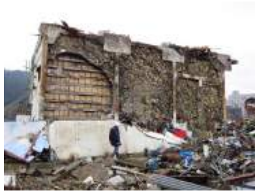
写真 6.2.1-7 塀を乗り越えた2階建て建築物
