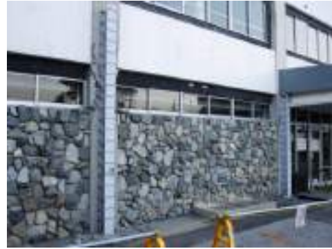
写真 5.2.1-10 応急補強した柱の被害
