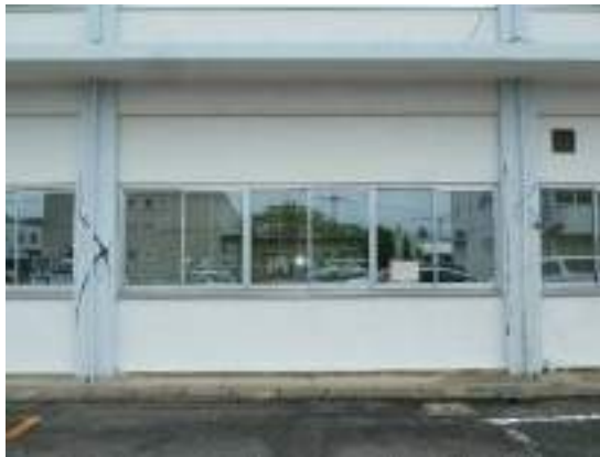
(a) 建築物H (損傷度 IV)
