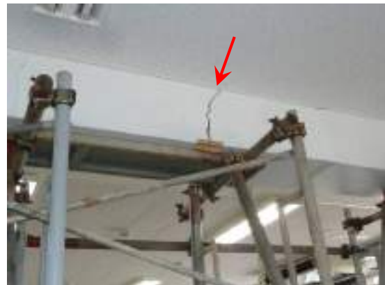
写真 5. 2. 3. 3-6 建物梁間方向の梁中間部に生じたひび割れ (9通り：ひび割れ幅 5mm)
