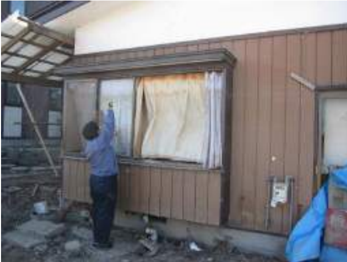
写真 6. 4. 1-2 開口部の窓ガラスの破損（浸水深約 2m）
