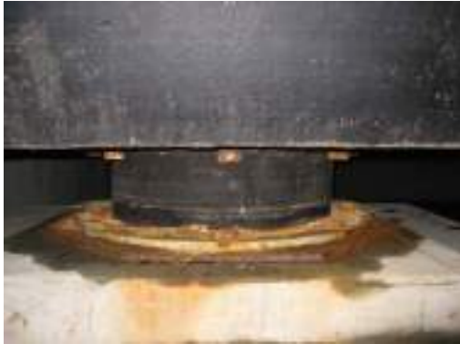
写真 5.5.1-10 高減衰積層ゴムの状況
