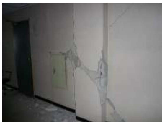
(a) 建築物C（損傷度IV）
