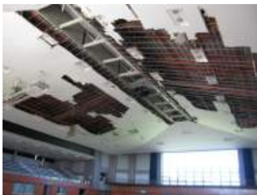
写真4.3-1 体育館の天井脱落被害
