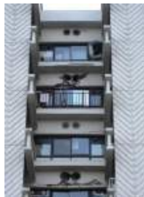
写真 5.2.1-8 境界梁（開口付き）の損傷
