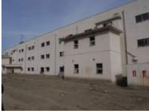
写真 11.3 気仙町今泉地区の学校の概観 (浸水深約10mと推定)
