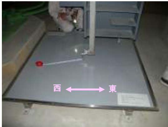
(a) 設置状況
