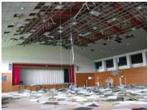
写真 5.7-3 天井板・下地材が脱落した被害
