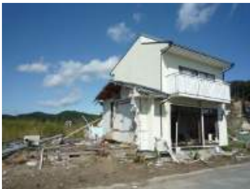
写真 2.8 一方の住戸が流失し、1つの住戸が残存した建物
