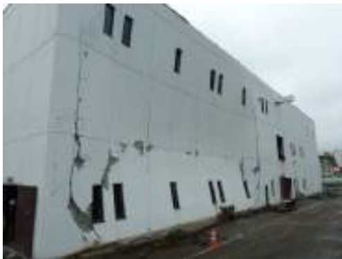
写真6.2.1-13 2、3階部分に床を持たない連層壁の面外破壊（建築物の奥の部分には2、3階部分に床がある）
