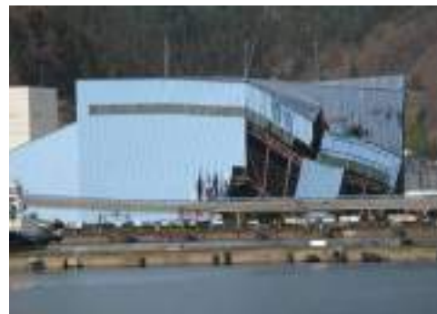
写真 6.3.1-8 部分的な崩壊
