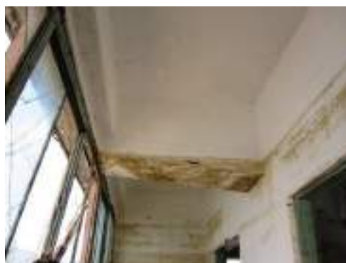
写真 6.2.1-6 建物内部の水の汚れの痕跡
