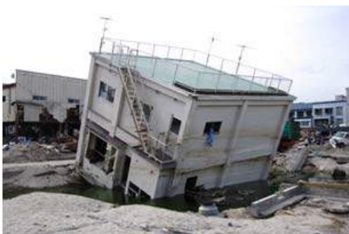
写真 6.2.1-10 洗掘による2階建て建築物の傾斜
