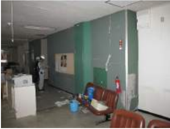
写真B-15 耐力壁側柱の主筋座屈(1階)
