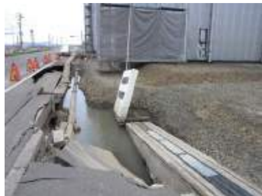
写真 5.5.1-9 建築物周囲の地盤変状
