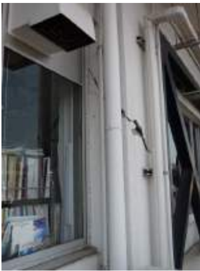
写真 B-49 補強ブレースが取り付け柱の構面内および構面外に生じたせん断破壊（C-8柱）
