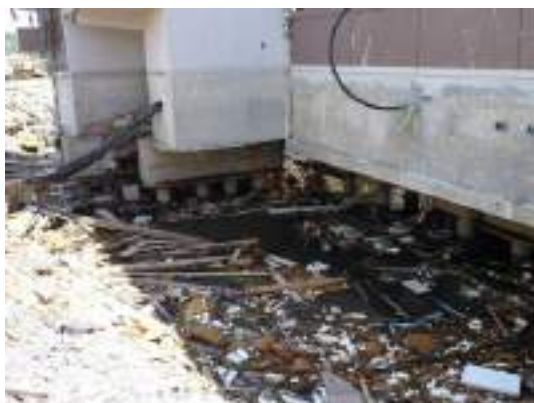
写真 6. 2. 2-5 基礎の洗掘 (中央部)
