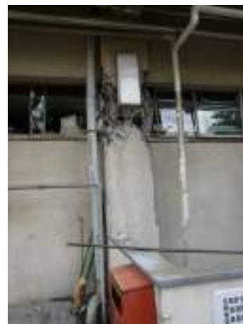
(b) 建築物I（損傷度V）
