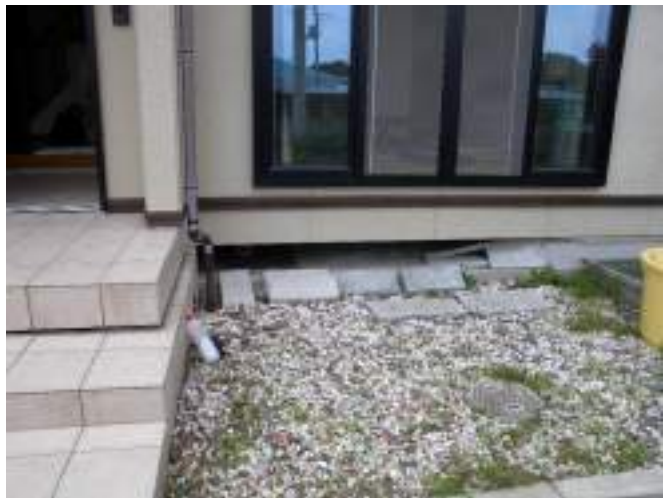
写真 5.5.1-37 基礎立上り部破損状況
