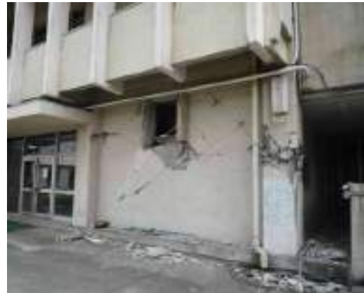
(b) 有開口耐力壁のせん断破壊
