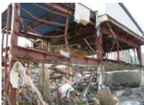
写真 6.3.1-15 間柱等の非構造部材の変形
