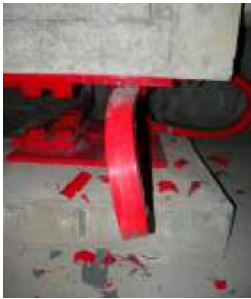
写真 5. 5. 1-22 U型鋼材ダンパーの変状
