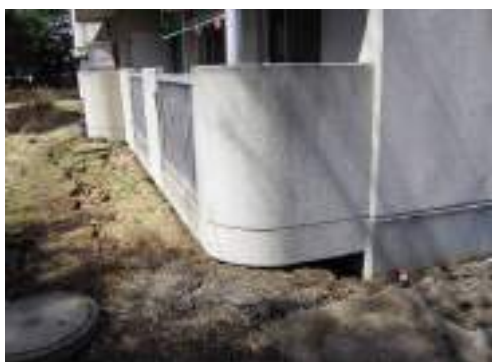
写真 5.2.1-3 4階建て建築物の傾斜
