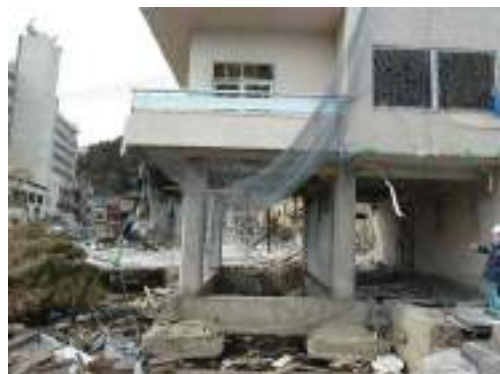
写真 6.2.1-9 洗掘による基礎の露出
