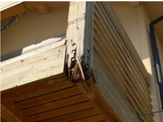
写真 4.15 折損した柱の接合部
