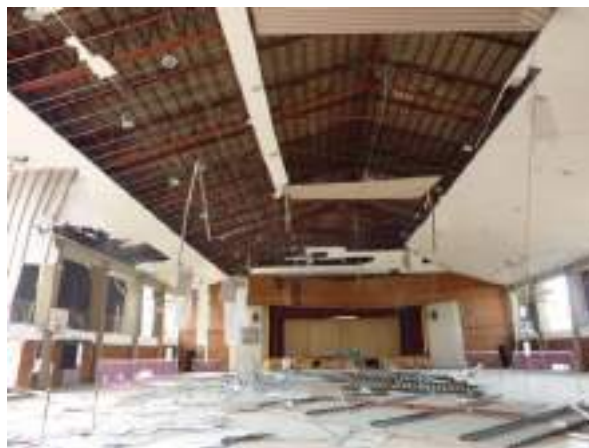
写真 5.7-2 在来工法による天井の脱落被害
