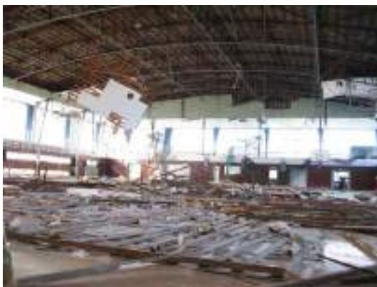
写真 5.3-5 天井、照明の落下
