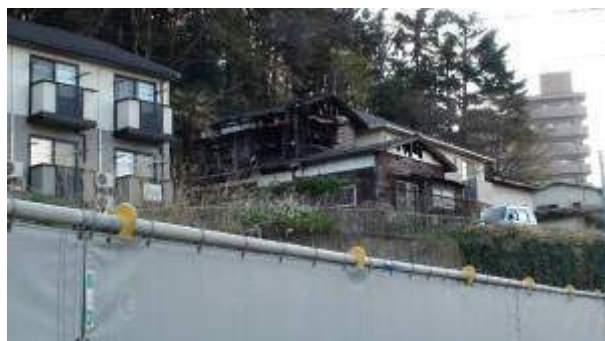
写真 7.2-7 仙台市太白区の住宅火災
