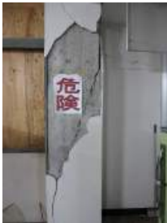
(a) 建築物 B (損傷度 III)
