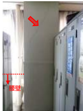
(b) 建築物 E (損傷度 III)
