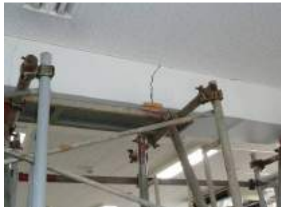
写真 5. 2. 2-9 梁中央部の曲げひび割れ (建築物J)
