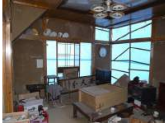
写真 5. 4. 2-28 内部の様子（内壁の損傷）
