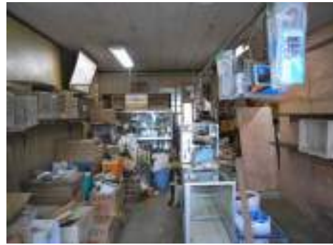
写真 5. 4. 2-44 内観 (1 階店舗部分の傾斜)
