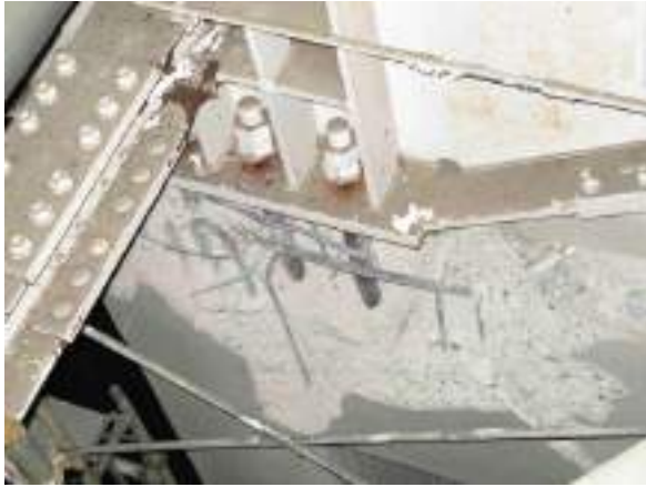
写真 5.3-10 妻壁と S 造屋根接続部のコンクリート破壊、ボルト変形
