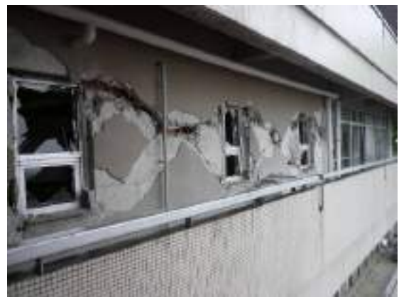
写真B-18 非構造壁のせん断破壊(2階)
