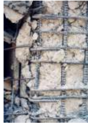
(c) 柱フープ端部の定着破壊 (90° フックの開き) (表 5. 2. 1-1 の 5))
