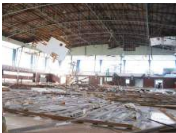
写真 5.7-1 木下地天井の脱落被害
