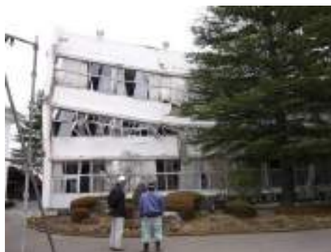
写真 5.2.1-2 中間階の層崩壊
