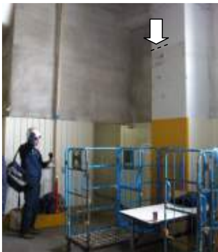
写真 5.5.1-8 隣棟内部（1F）の浸水跡
