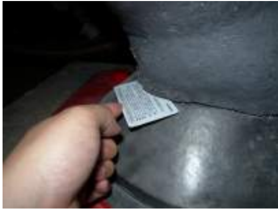
写真 5. 5. 1-18 鉛ダンパーのひび割れ状況
