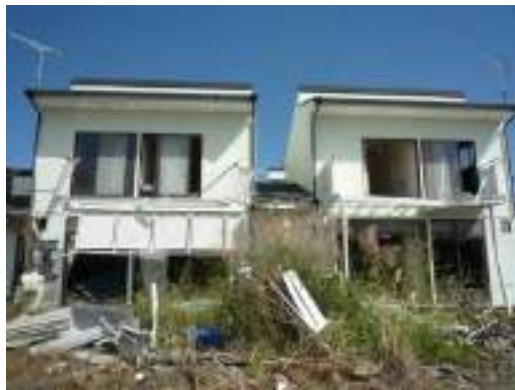
写真 2.7 大きく損傷し、残存した住戸
