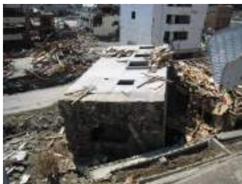
写真 6.2.1-5 4階建て杭基礎建築物の転倒
