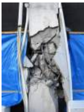
(a) 短柱のせん断破壊
