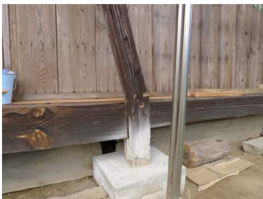
写真 5. 4. 2-17 足固めの高さでの柱の折損
