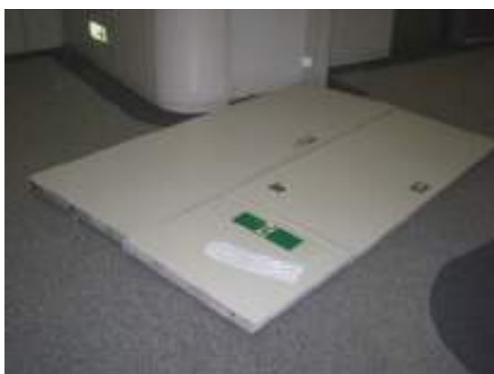
写真 7.4-2 枠から外れた防火戸 7-8)
