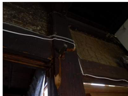
写真 5. 4. 2-18 内部の柱の折損（垂れ壁下端）
