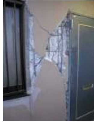
写真 5.2.1-12 非構造壁（玄関側）のせん断破壊
