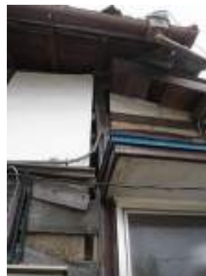
写真 5. 4. 2-8 柱の曲げ変形（台所と居室の境）
