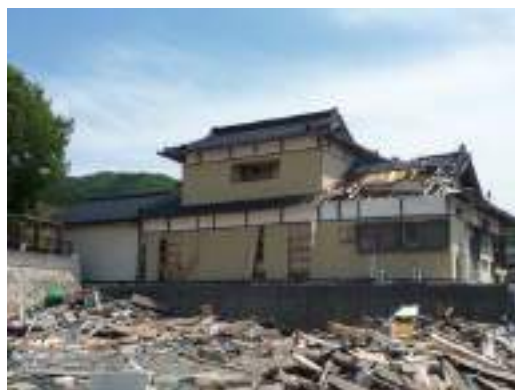
写真 10.5 赤碕町海岸付近で流失を免れた 木造家屋 (浸水深 6 m 以上)
