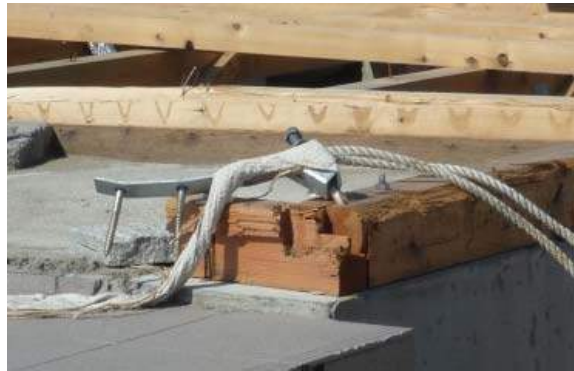
写真 6. 4. 1-20 ホールダウン金物が破損した例
