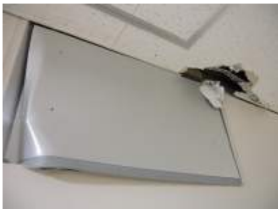
写真 5.5.1-2 衝突等によるカバーの破損
