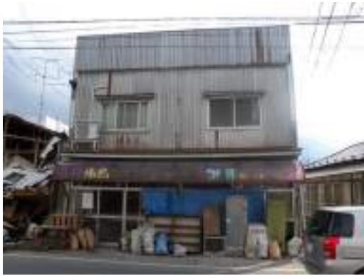
写真 5. 4. 2-43 建物の外観 (1 階傾斜)
