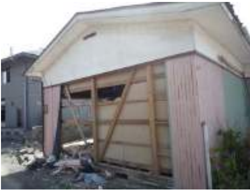
写真 10.15 写真 10.14 の筋かい
