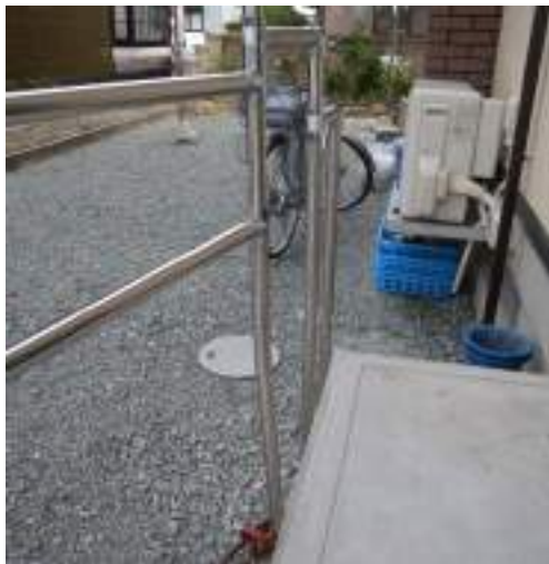
写真 5.5.1-45 勝手口の手すりの損傷
