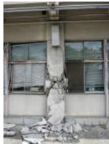
(c) 建築物I（損傷度V）
