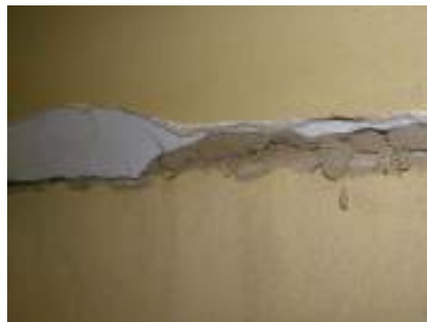
写真 5. 4. 2-2 土塗り壁等の剥落
