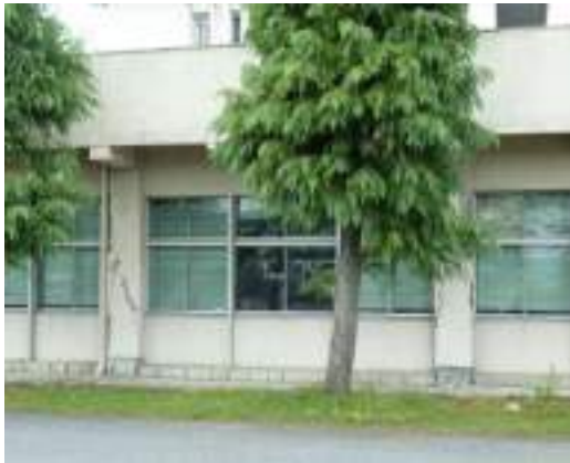
(a) 南側構面柱のせん断破壊
