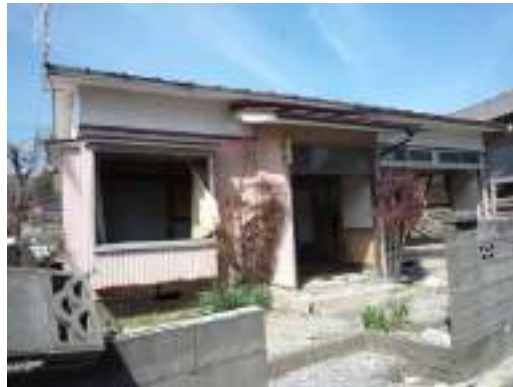
写真 10.14 比較的軽微な構造仕様で残留した木造住宅（浸水深 5 m）
