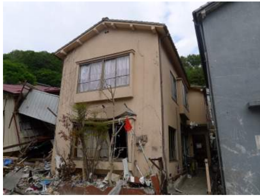
写真 4.2 土台と基礎がずれた木造
