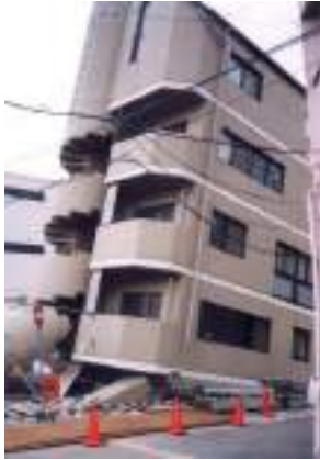
(a) ピロティ階の崩壊 (表 5. 2. 1-1 の 13))
