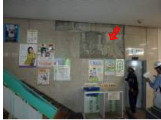
写真 5. 2. 2-13 耐力壁のせん断ひび割れ (建築物 B、損傷度 II)
