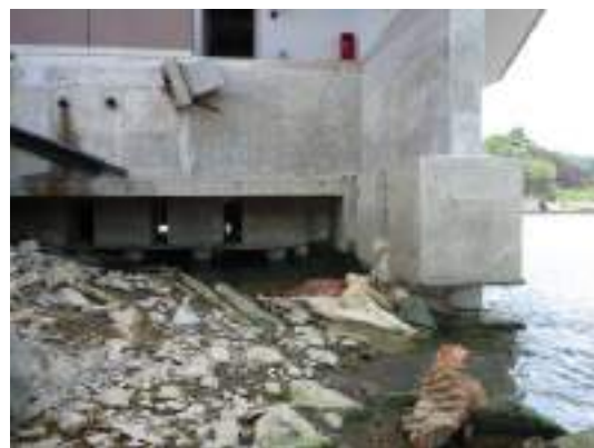
写真 6. 2. 2-6 基礎の洗掘 (妻側)
