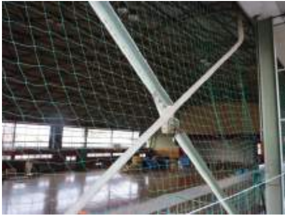
写真 5.3-1 ブレース材の座屈と接合部破断
