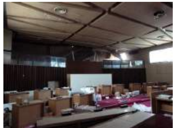
(b) 天井落下 (建築物 I)
