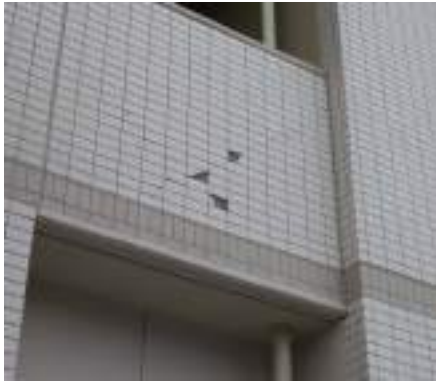
写真 5.5.1-13 外装タイルの落下
