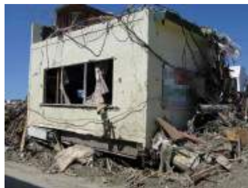
写真 6.2.1-2 2階建て建築物の層崩壊
