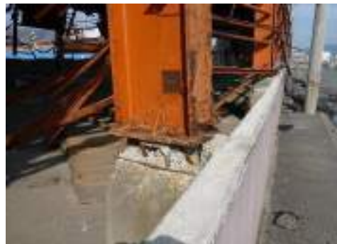
写真 6.3.1-14 柱脚部の移動(コンクリート塊や道路の舗装アスファルト等の漂流物によると考えられる)
