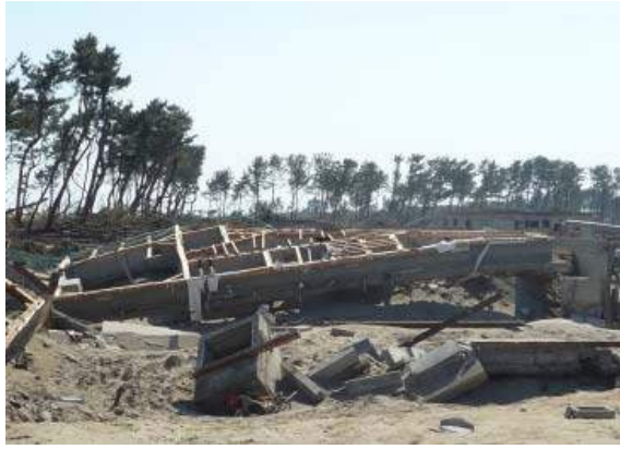
写真 6. 4. 1-18 基礎が流失した例
