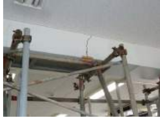
写真 B-54 梁間方向の梁中間部に生じた ひび割れ (㊟通り：ひび割れ幅 5mm)
