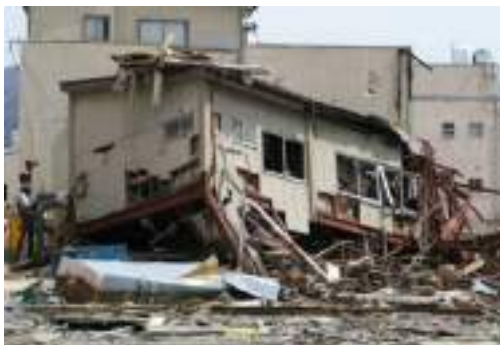
写真 6.3.1-7 2階建てS造の1階の崩壊
