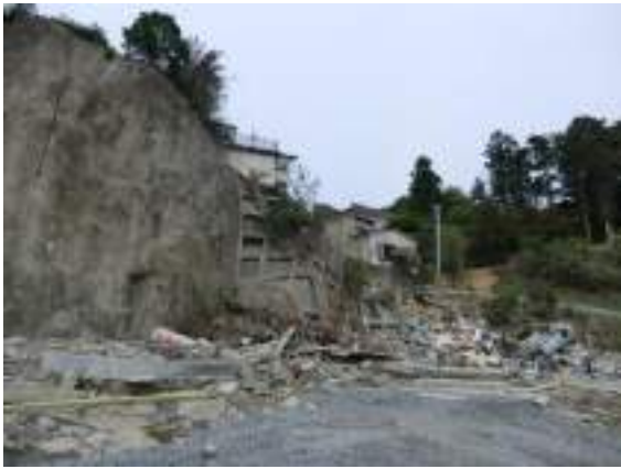
写真 13.20 宮ヶ崎川尻の住宅被害
