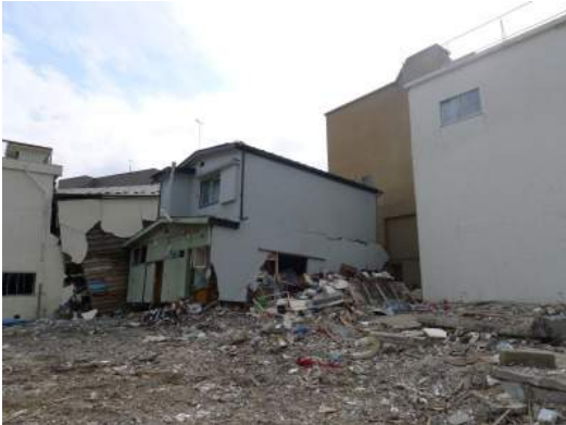
写真 4.5 1F 柱脚部が崩壊した木造
