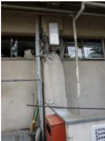
写真 B-43 短柱のせん断破壊 (損傷度 V : ㊦通り⑤柱)
