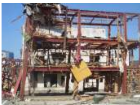
写真 6. 3. 1-9 傾斜した重層建築物
