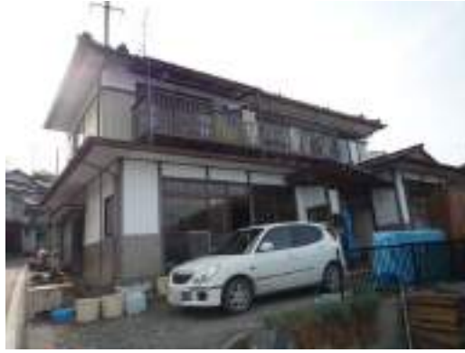
写真 12.4 浸水深 3.4 m の木造住宅
