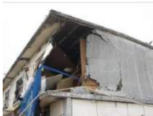
写真 6.2.6-2 2階妻壁の損傷
