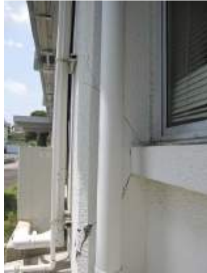
写真 B-50 補強ブレースが取り付け柱の構面外に生じたせん断破壊（A-8柱）
