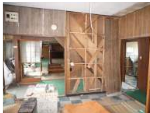
写真 5. 4. 2-22 内観と座屈した筋かい
