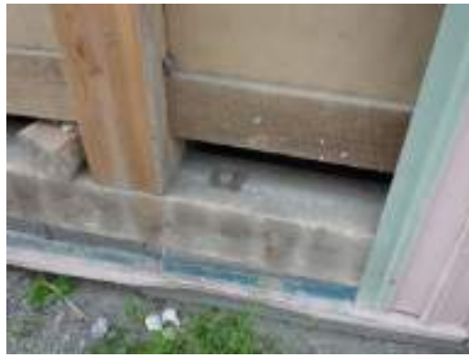
写真 10.16 写真 10.14 のアンカーボルト
