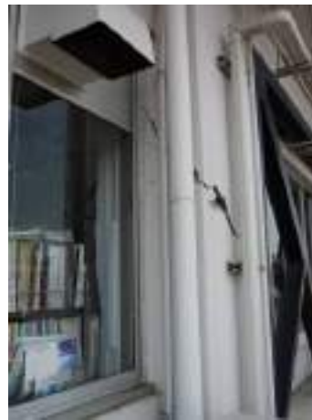
(b) 建築物J (損傷度 IV)
