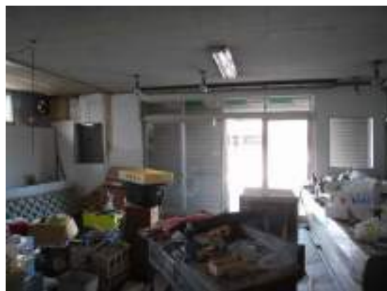
写真 5. 4. 2-32 内部の様子（内装材の落下）
