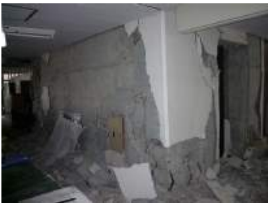
写真B-17 耐力壁のせん断破壊(2階)
