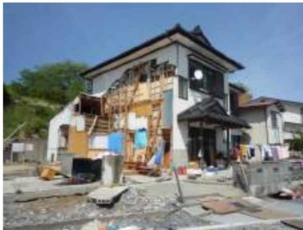
写真6.4.2-6 最大浸水深が7mを超える場所に建ち、流出を免れた木造住宅
