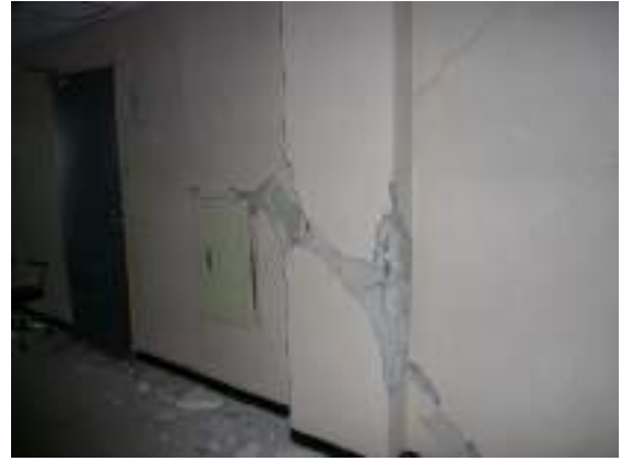
写真B-16 長柱のせん断破壊(2階)
