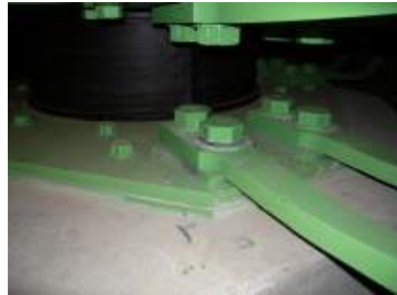
写真 5. 5. 1-32 鋼材ダンパー基部のボルトの緩み
