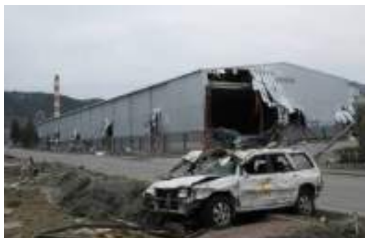
写真 6. 3. 1-12 倉庫（津波の流出口として妻壁および開口部が外側に変形）
