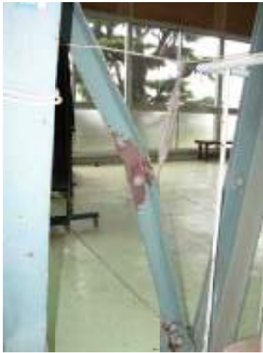
写真 5.3-3 ラチス柱斜材の座屈
