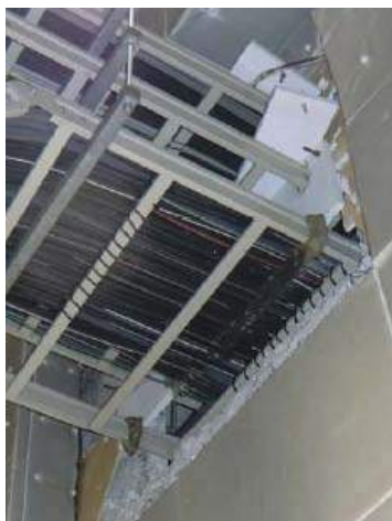
写真 7.4-1 防火区画貫通部の損傷 7-8)
