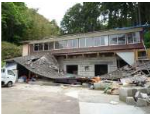
写真 20.15 下屋が崩壊した作業小屋 (⑪)
