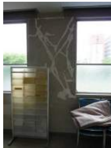
(b) 方立て壁のせん断破壊 (建築物 E：雨漏り防止の暫定補修)
