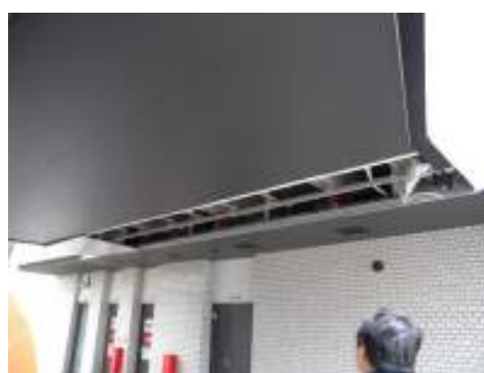
写真 5.5.1-3 天井カバーの脱落
