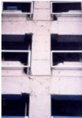
(d) 柱はり接合部の破壊 (表 5. 2. 1-1 の 10))
