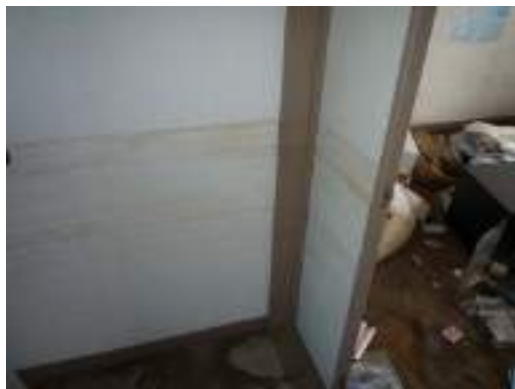
写真 2.8 2階内壁に残る浸水痕
