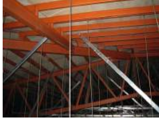
写真 5.3-17 斜め補剛材のはずれ
