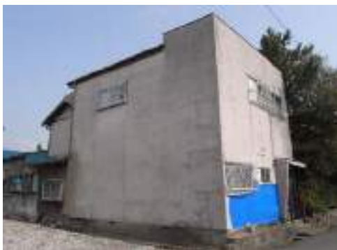
写真 5. 4. 2-29 建物外観（増築部のモルタルの亀裂）
