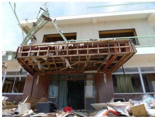
写真 8.2 庇がせん断変形した鉄筋コンクリート造
