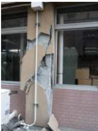
写真 B-29 南構面柱せん断破壊（損傷度 IV）
