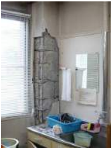
写真 B-27 柱ひび割れ、かぶりコンクリート剥落 （損傷度 IV）
