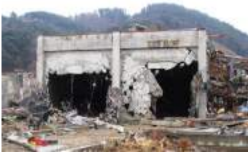
写真6.2.1-12 非構造壁の面外破壊
