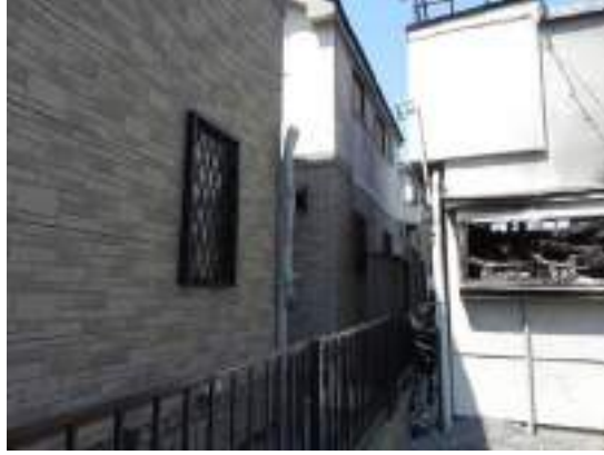
写真 7.2-24 火元家屋の南側の類焼した2棟 (奥：ガラスが割れて水損、手前：雨樋の溶融)
