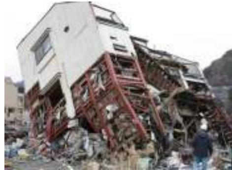
写真 6.3.1-6 3階建てS造の1階柱脚部の引き抜けおよび1階柱の座屈による転倒
