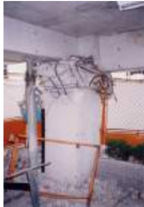
(e) 軸力の大きな柱の破壊 (表 5. 2. 1-1 の 3))
