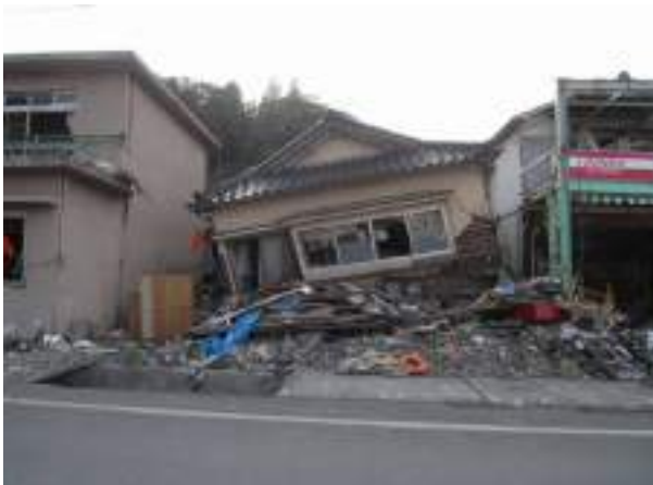
写真 5.3 層崩壊した木造住宅
