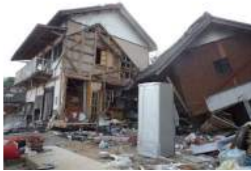
写真 12.12 倒壊した既存部分と増築部分との接続部分
