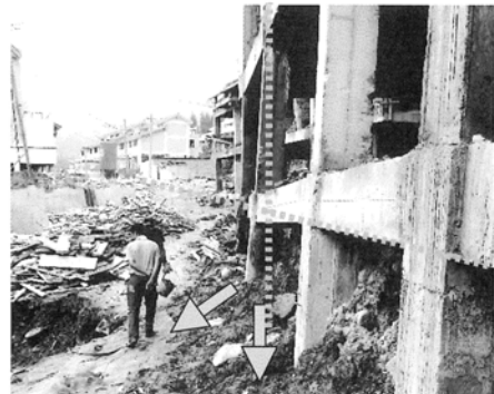
写真8 擁壁破壊と土砂流出（写真上）による建物の不同沈下（写真下）
