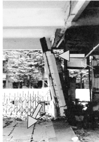
写真4 転倒した(手前)/転倒しそうな(奥)レンガ壁
