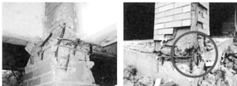
写真6 柱頭・柱脚に曲げ圧壊が生じた建物
