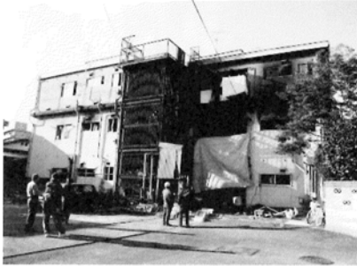
写真5 焼損建物入口側
