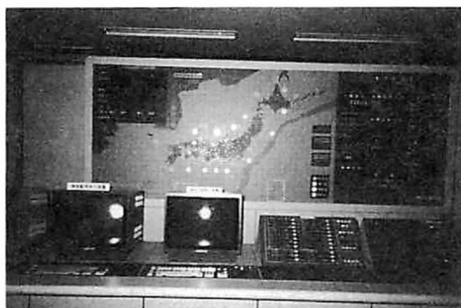
写真4 総合監視システム
