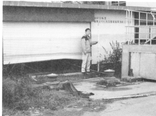
写真—3 大津港での津波痕跡(重油と思われる 痕跡が壁に残っている)
