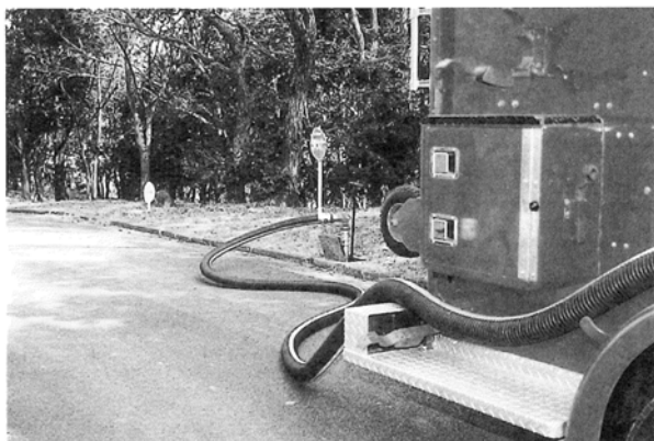
サイクリング道に設けられた消火栓から取水後方の低い標識は止水栓の位置を示す
