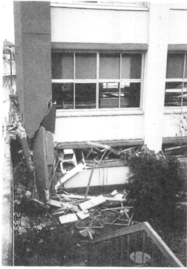
写真 2 阪神・淡路大震災における被災状況
