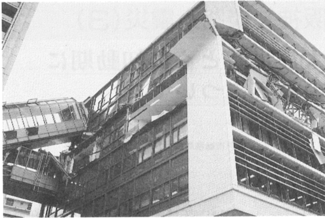
写真1 市方舎2号館の被災害状況
