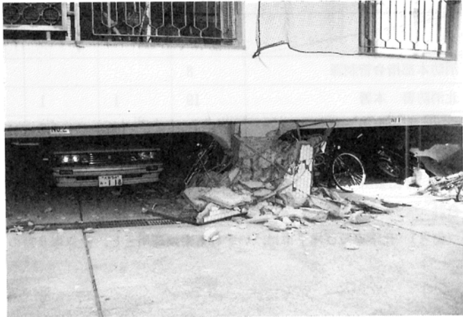
写真 1 RC 造 5 階建共同住宅 1 階車庫座屈現場
