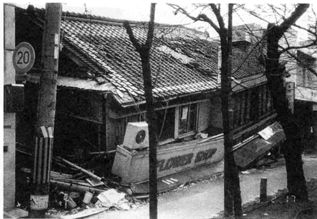
写真2 木造家屋の倒壊状況
