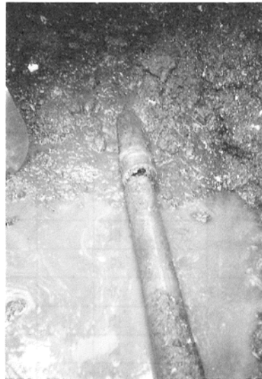
写真1 配水管の折損
