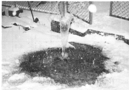
写真2 仕切弁からの漏水
