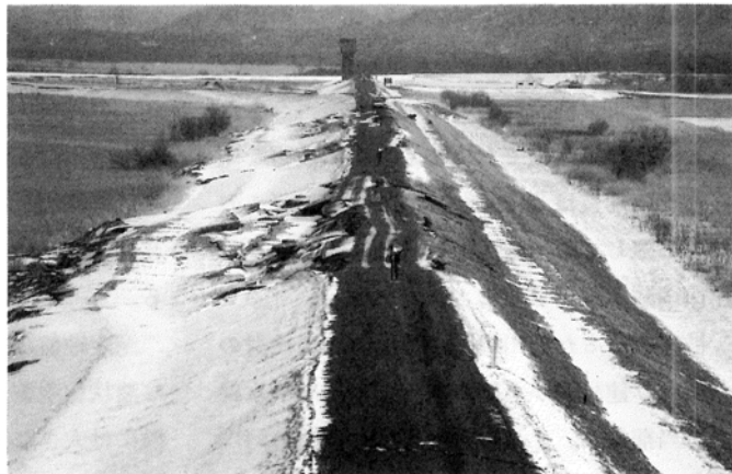
写真2 釧路川の堤防被害
