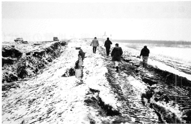
写真1 十勝川の堤防被害
