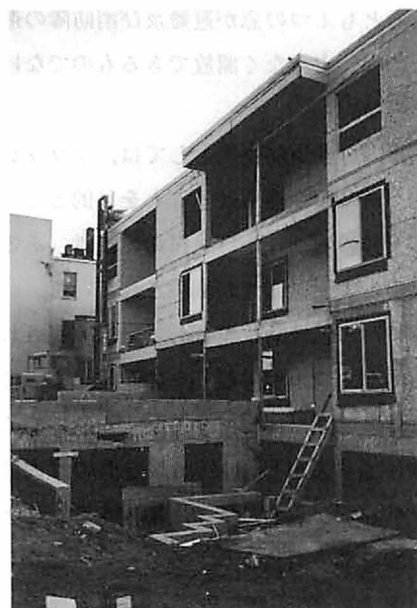
写真1 RC造の地下部分の上に木造3階建てが乗っている
