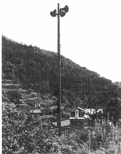
土石流予警報装置（鳴滝地区）
